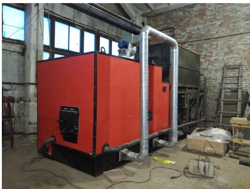
Алтайский край г.Новоалтайск (750кВт на опилках и стружке) смонтирована котельная под ключ
