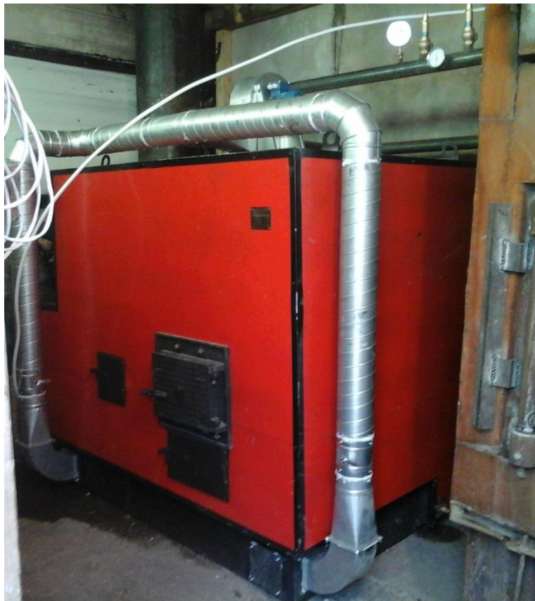
Иркутская область, Боханский район, с.Тихоновка (450кВт)
