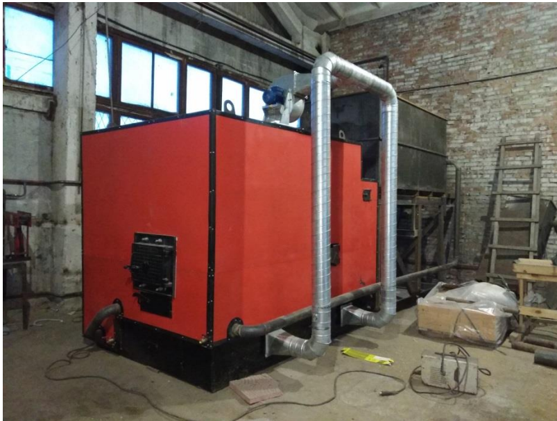
Алтайский край г.Новоалтайск (Восток) (750кВт на опилках и стружке) смонтирована котельная под ключ
